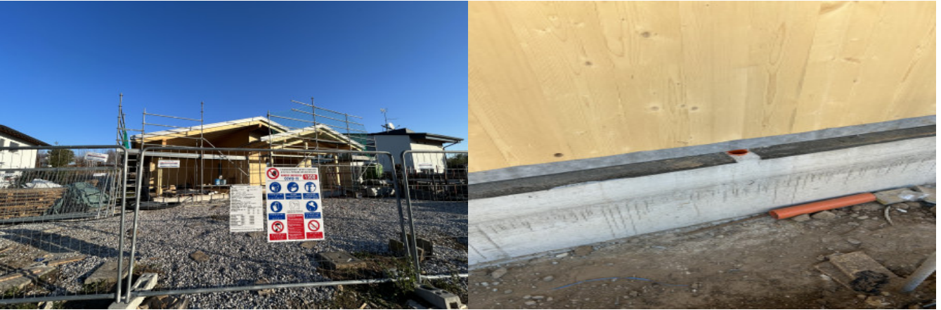
Prese aria che danno su struttura in legno
